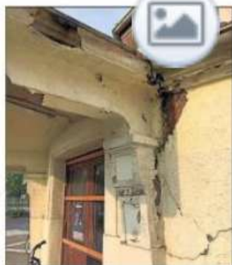
Die Bausubstanz des Empfangsgebäudes ist angegriffen.
